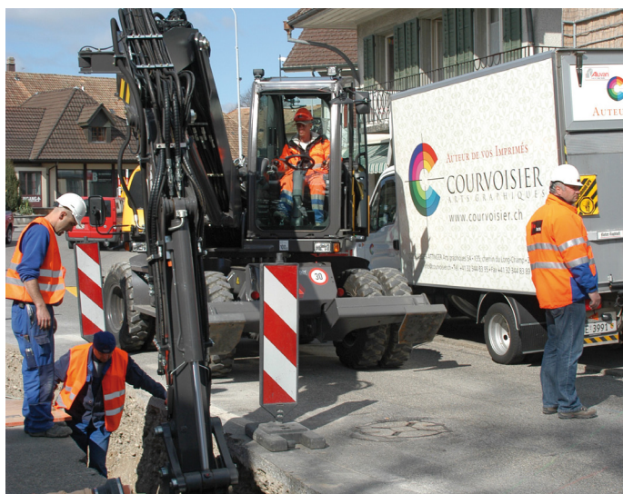
Beim Richten der Fernheizungsrohre kann der Mecalac714MWe dank Knickarm und grosser Reisskraft so richtig zur Sache gehen.
