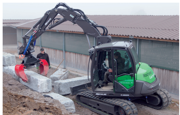
Auf engstem Raum und dank der hohen Hubleistung sowie der äusserst präzisen Steuerung und der grossen Reichweite kann der Mecalac 8MCR die schweren und sperrigen Natursteinelemente auf den Punkt genau am richtigen Ort platzieren.
