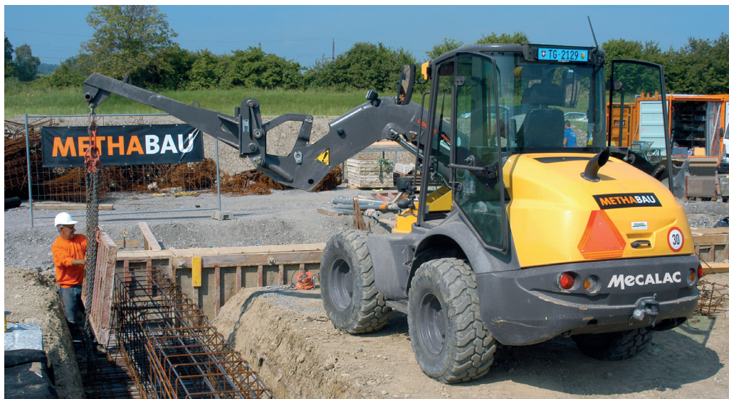
Bei der Platzierung von Schalungselementen beweist der Schwenklader Mecalac AS 900 seine Vielseitigkeit.
