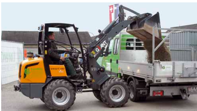
Beim Beladen von LKW's oder bei Erdbewegungsarbeiten kann der Radlader seine grosse Kraft und Standfestigkeit beweisen.
